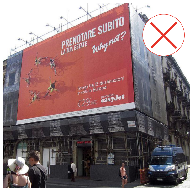
78 - Nevhodný príklad umiestnenia veľkoplošnej reklamy na ochrannom pletive lešenia.
