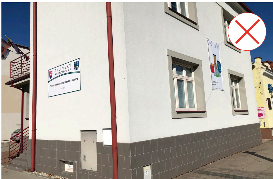
32 - Nevhodné umiestnenie a dizajn tabuľového označenia významnej prevádzky ako i nevhodné umiestnenie a spôsob kotvenia informačnej plochy na fasáde objektu.
