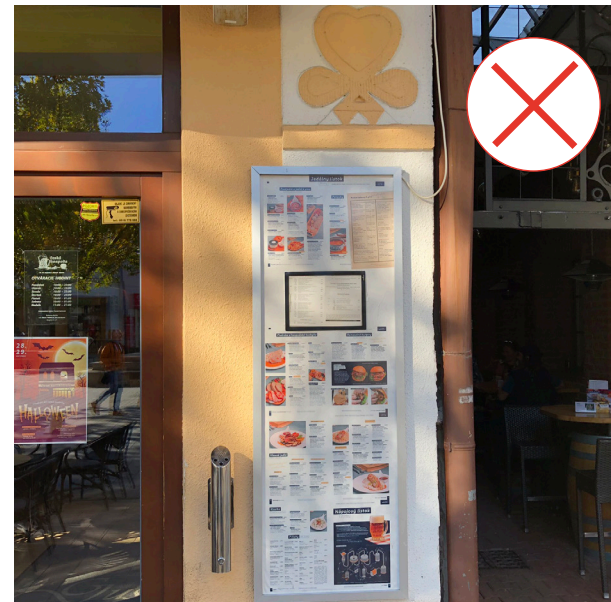
59 - Nevhodný príklad umiestnenia a veľkosti vitríny prekrywajúcej ornamentálne prvky budovy s viditeľným napájacím káblom.
