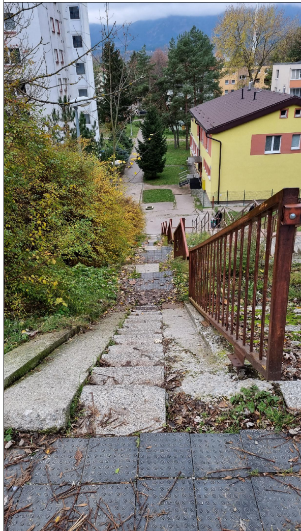
SCHODISKO S RAMPOU A JEHO TECHNICKÝ STAV.
