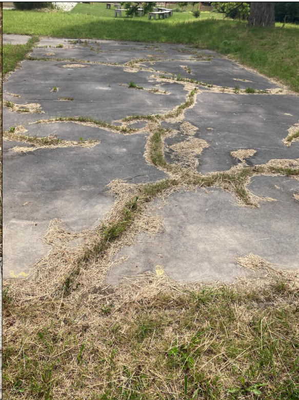
ZNIČENÁ ASFALTOVÁ PLOCHA.
