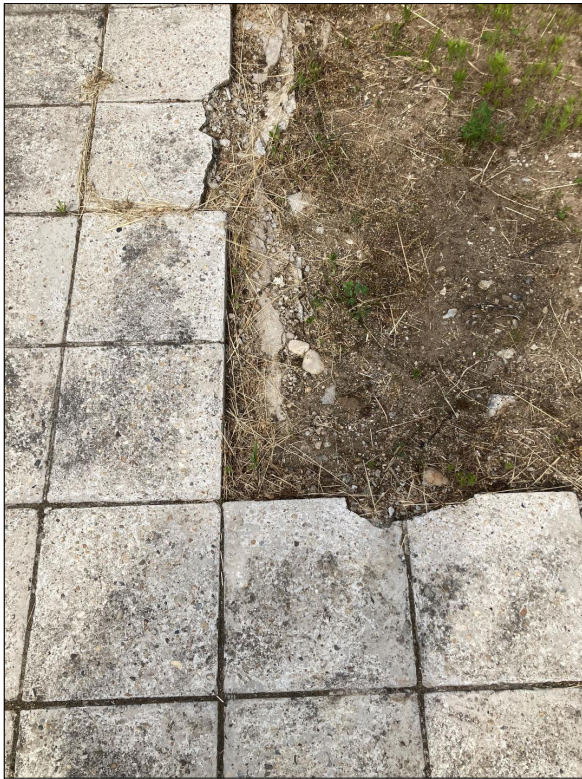
ZNIČENÁ SPEVNENÁ PLOCHA Z BETÓNOVÝCH TVÁRNIC.
